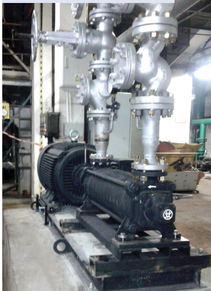
Электростанция в Мельце - Насос WH
